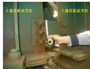
写真3 破断した連結工
