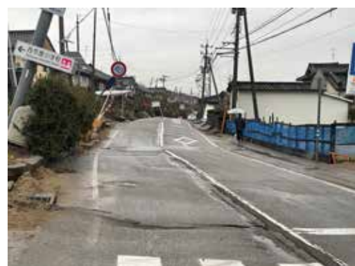
図-3 西荒屋地区の被害写真
