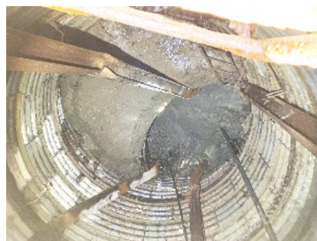
図-1 せん断破壊した集水井
